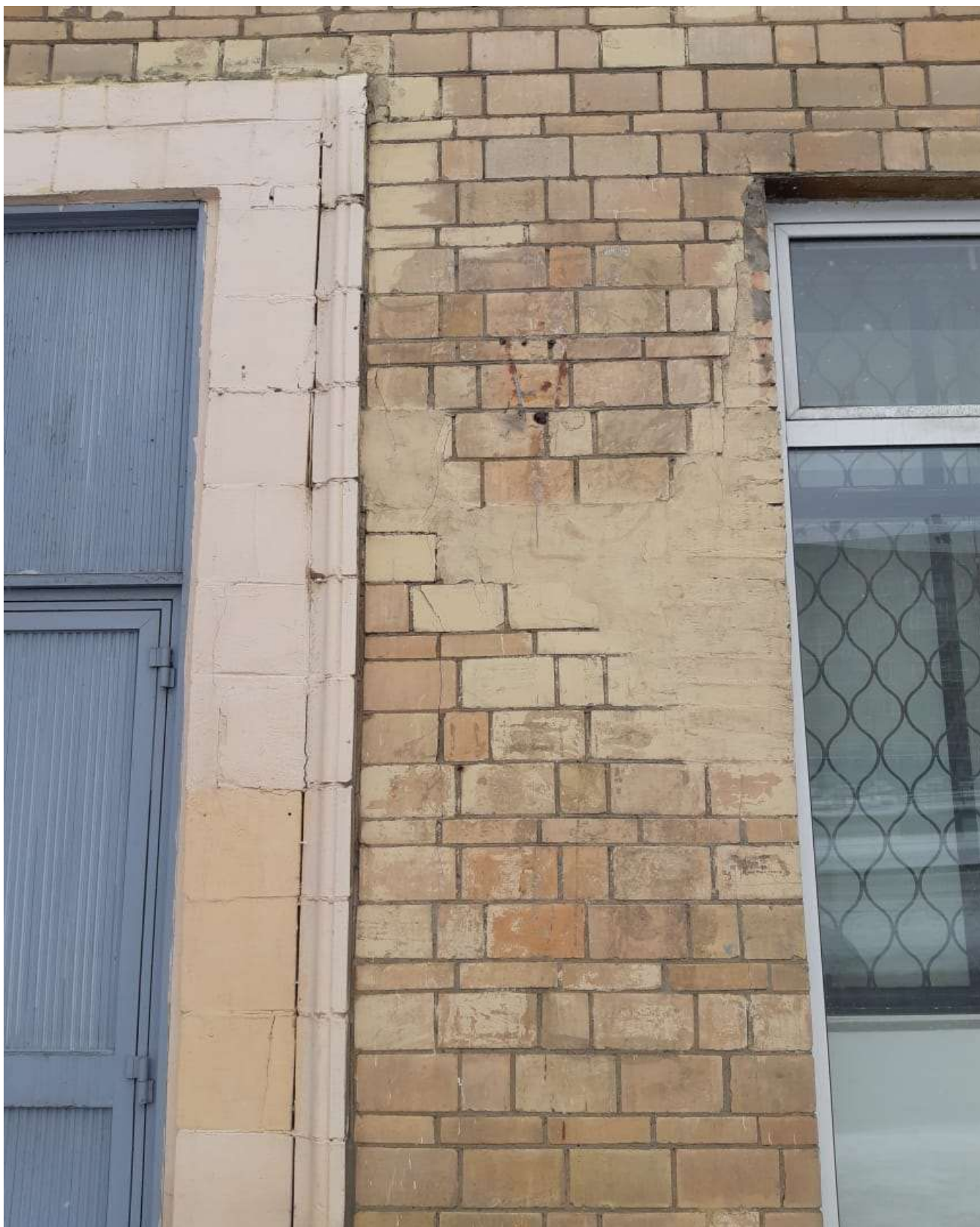
Фото 11. Разрушение кладки на ранее восстанавливаемом участке
