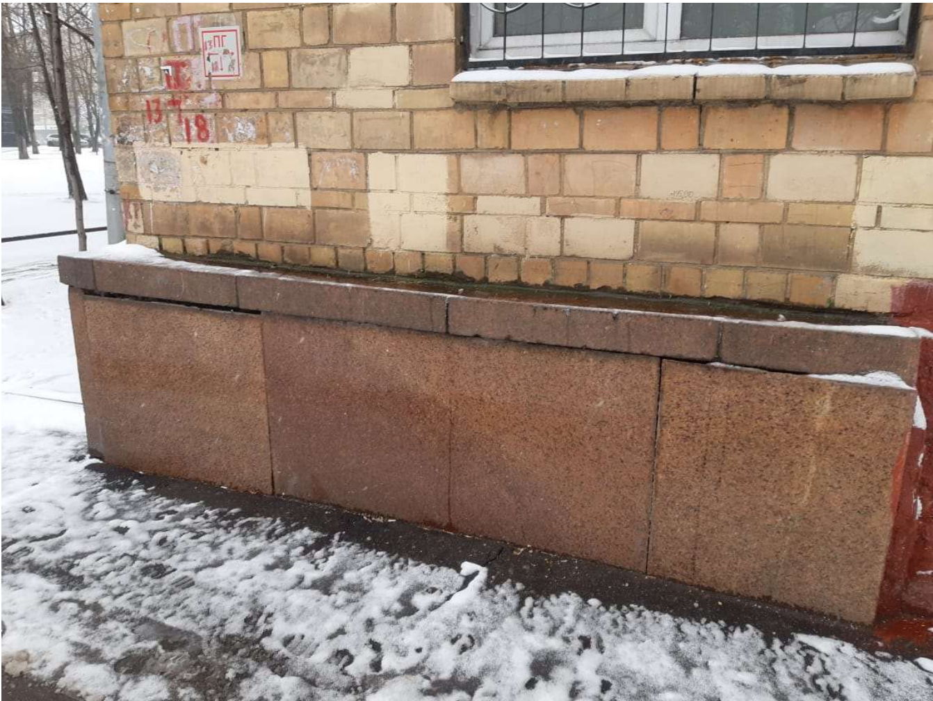
Фото 20. Разрушение отделки цоколя
