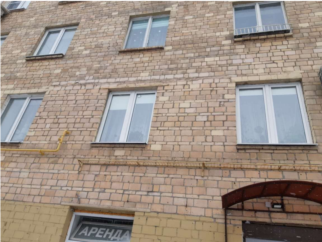
Фото 12. Состояние газовой магистрали подключение абонентов здания
