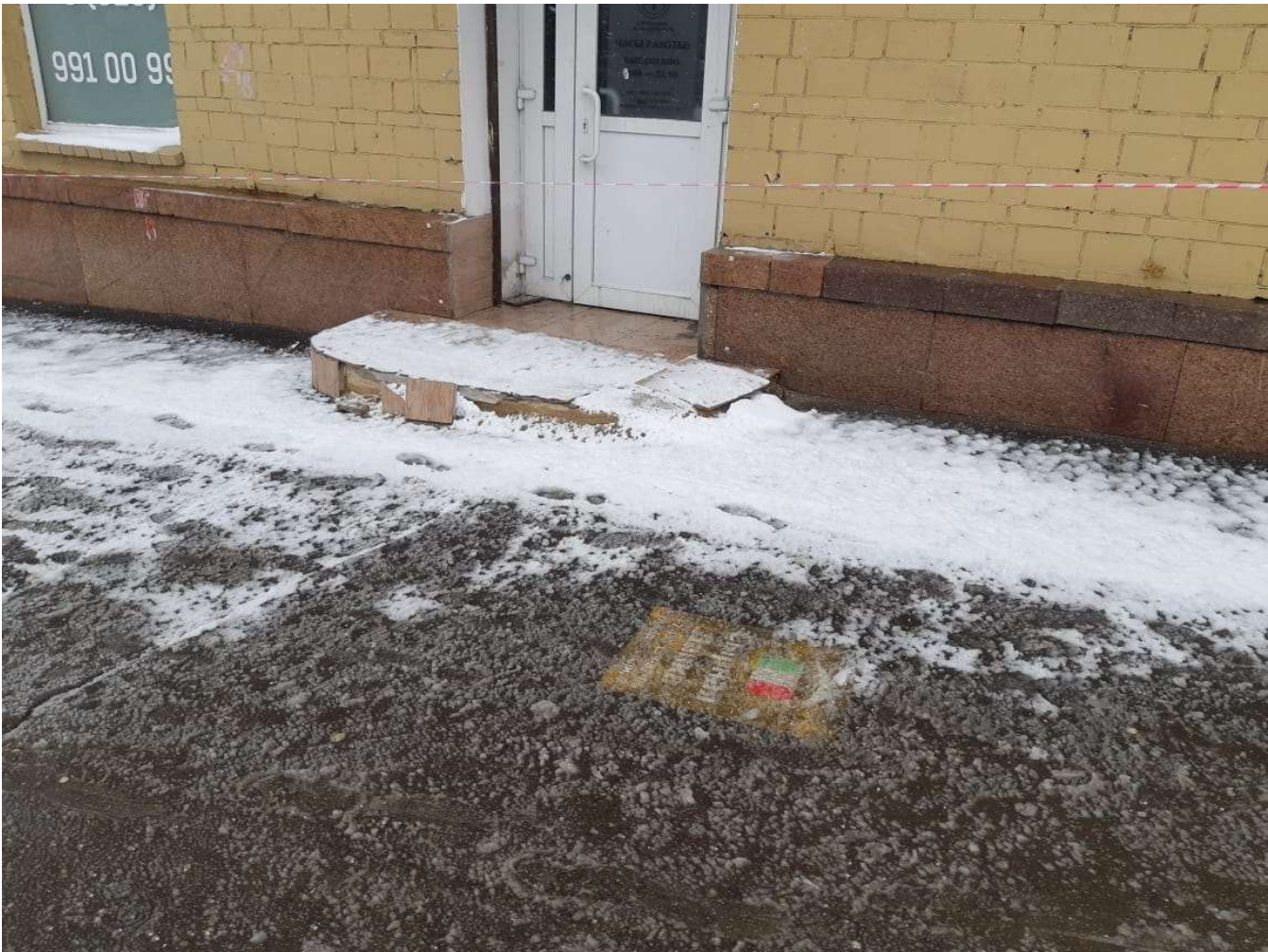
Фото 13. Разрушение отделки входной группы
