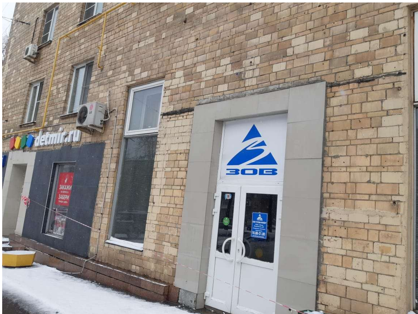
Фото 9. Разрушение отделки цоколя
