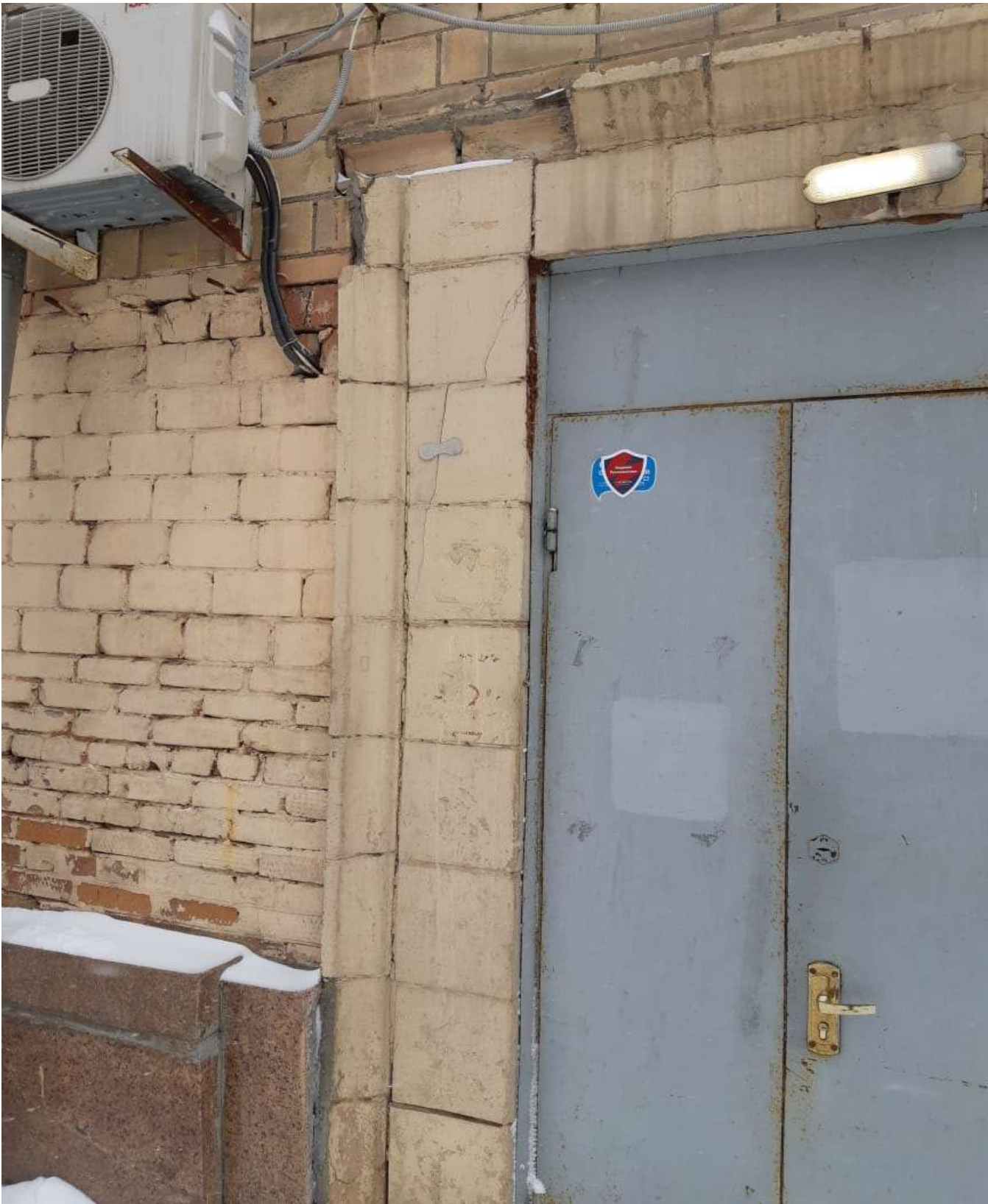
Фото 33. Состояние входных групп технических помещений здания
