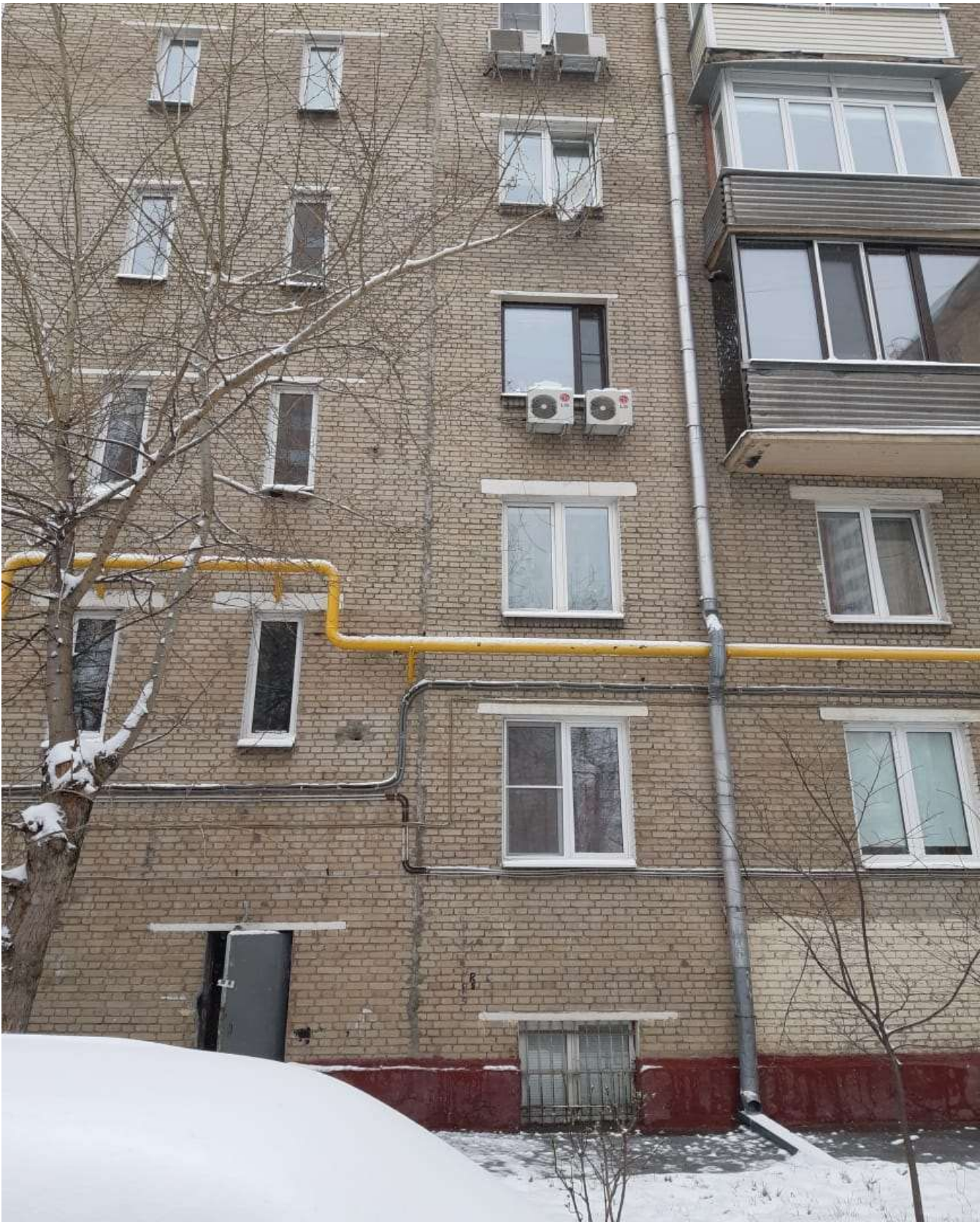
Фото 29. Общее состояние деформационного шва
