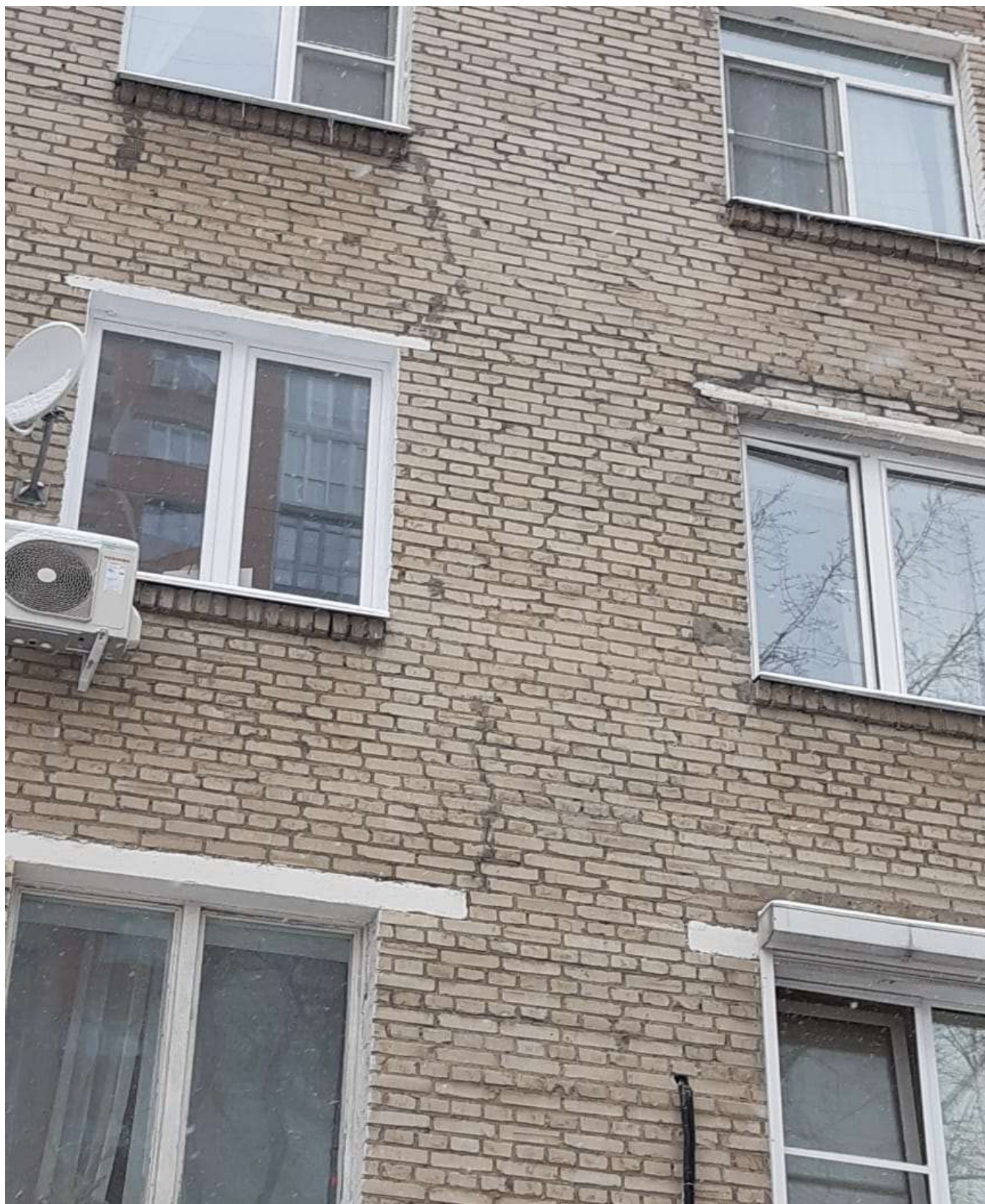
Фото 26. Участки некорректного восстановления трещин облицовочной кладки стен
