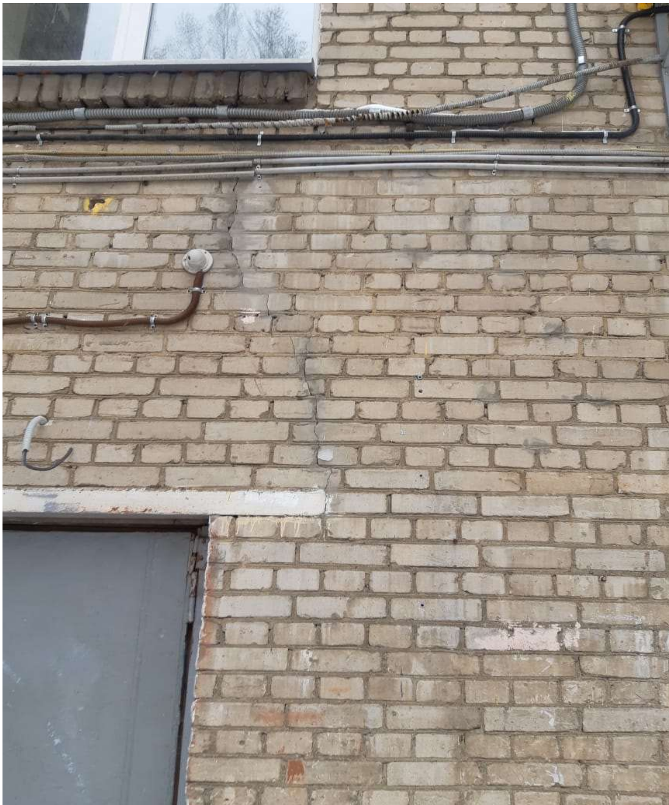
Фото 21. Трещина облицовочного слоя кладки
