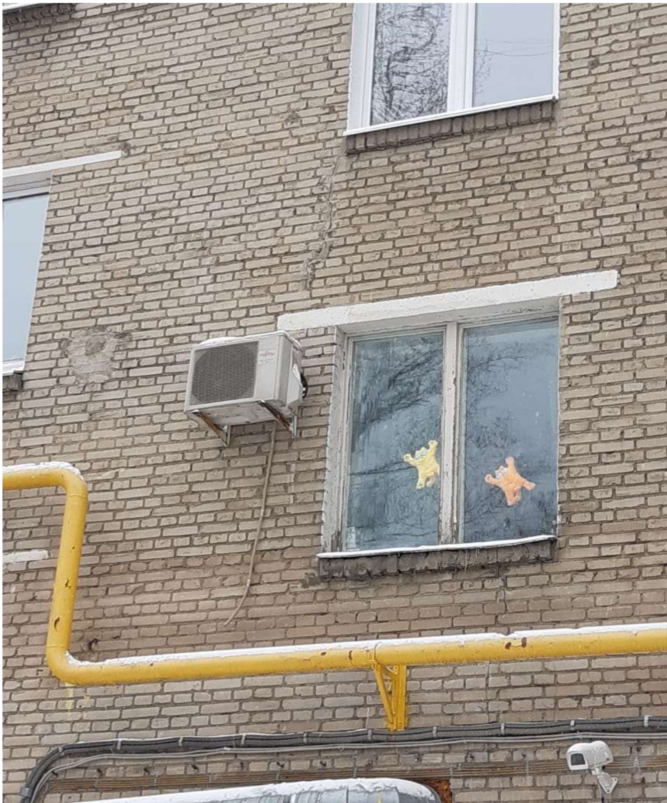
Фото 27. Участки некорректного восстановления трещин облицовочной кладки стен
