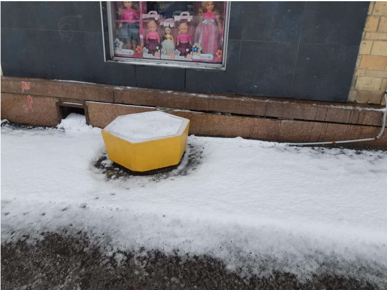
Фото 7. Разрушение отделки цоколя
