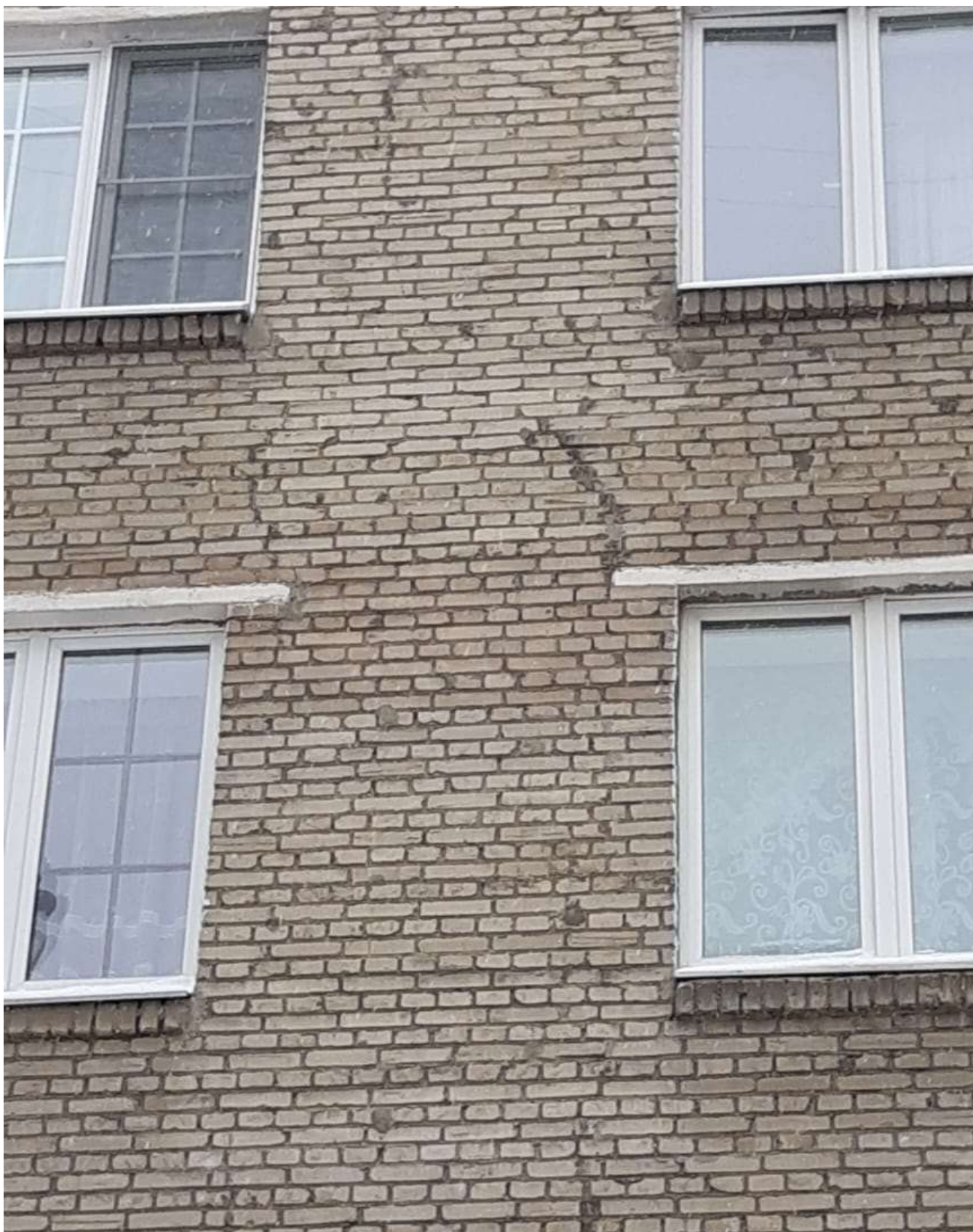
Фото 23. Участки некорректного восстановления трещин облицовочной кладки стен
