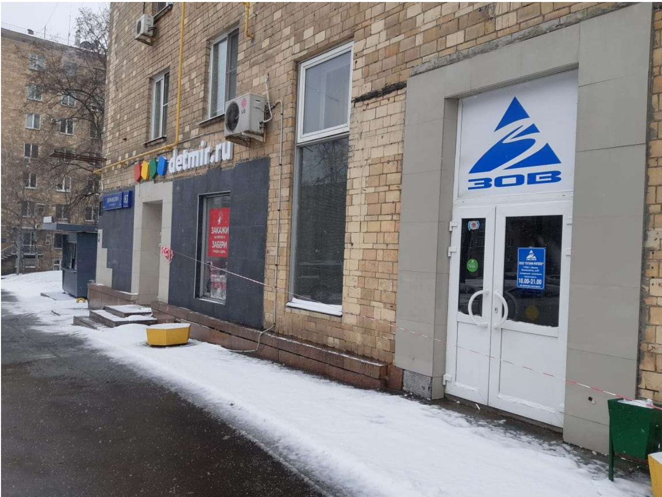
Фото 8. Разрушение отделки цоколя
