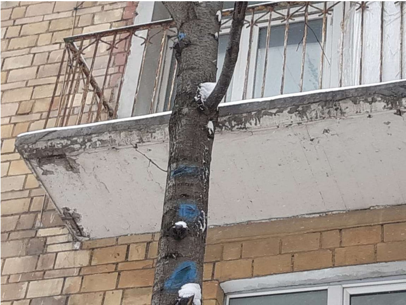
Фото 16. Разрушение торцов балконных плит
