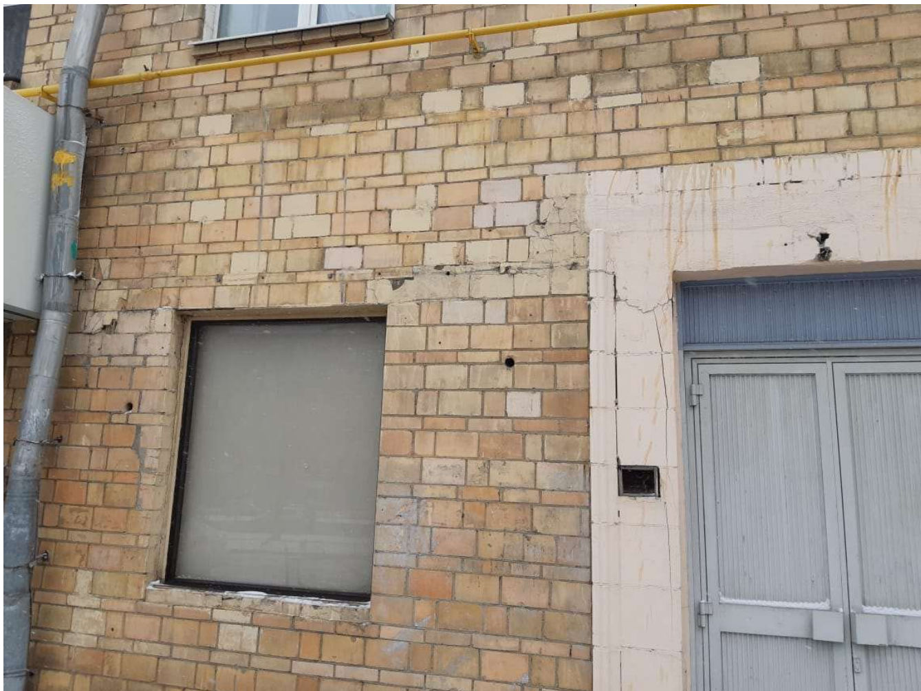
Фото 14. Разрушение кладки наружных стен. Трещина в зоне опирания перемычки входной группы.
