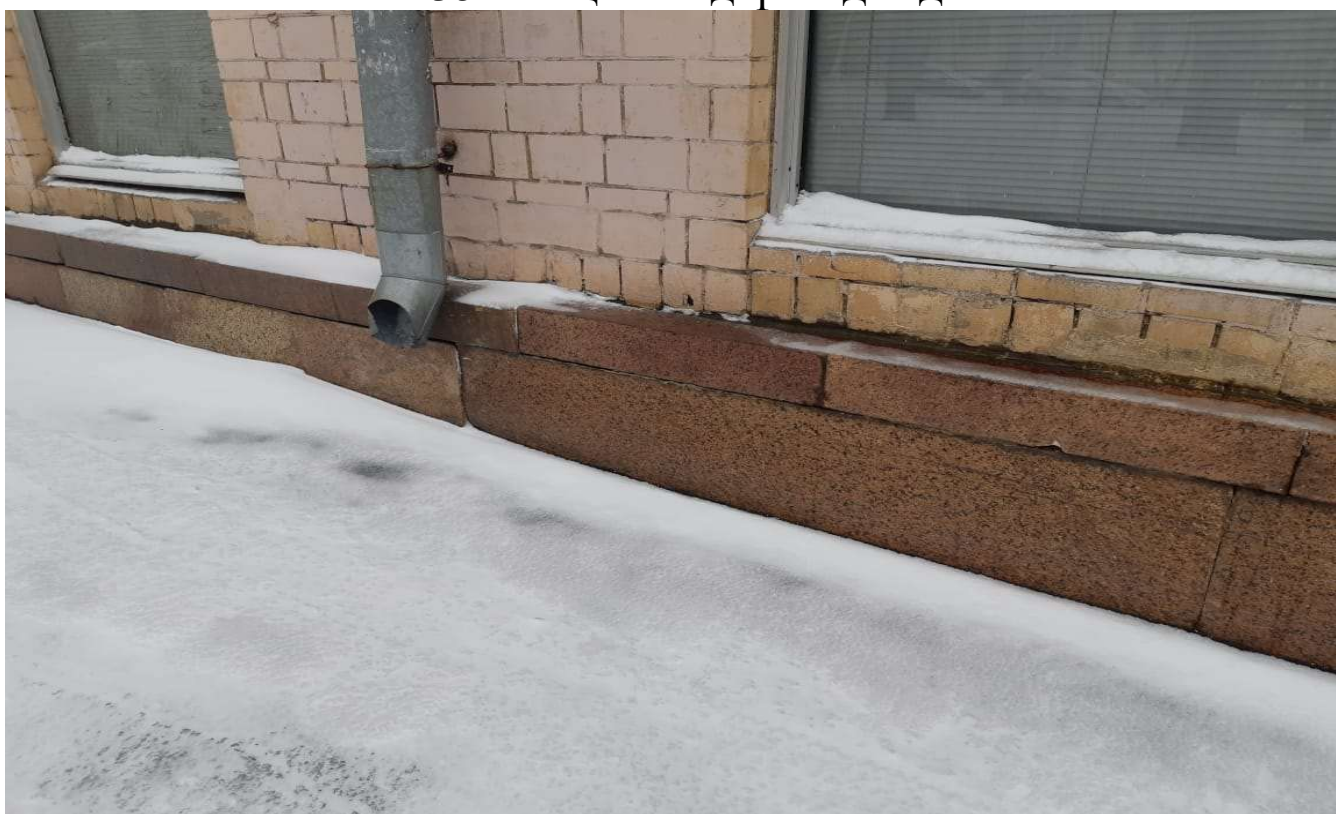
Фото 36. Разрушение отделки цоколя в зоне наружного водостока
