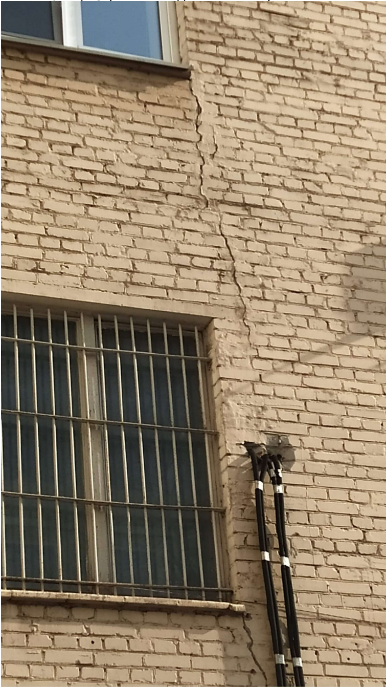
Фото 10. Трещина фасада здания по адресу: Москва, Ленинский проспект, д.78.
