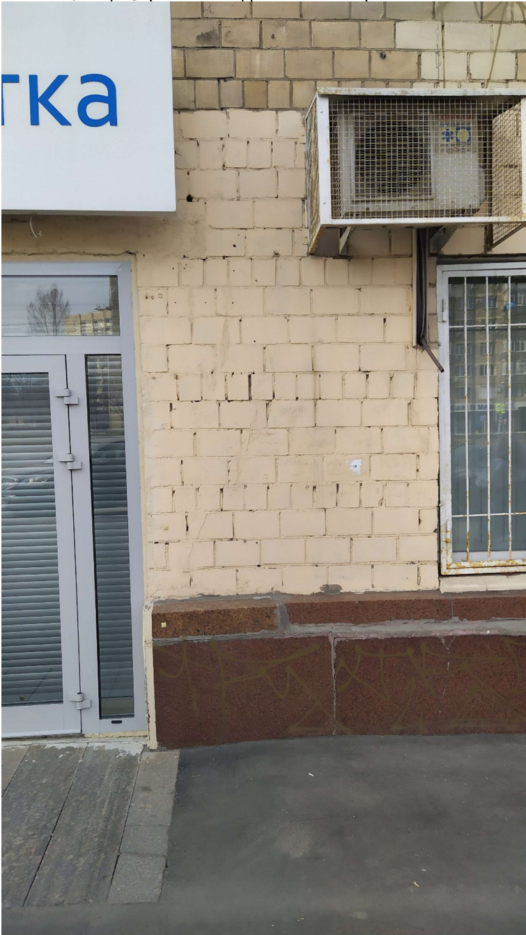
Фото 24. Трещина фасада здания по адресу: г. Москва, Ленинский проспект, д. 78.
