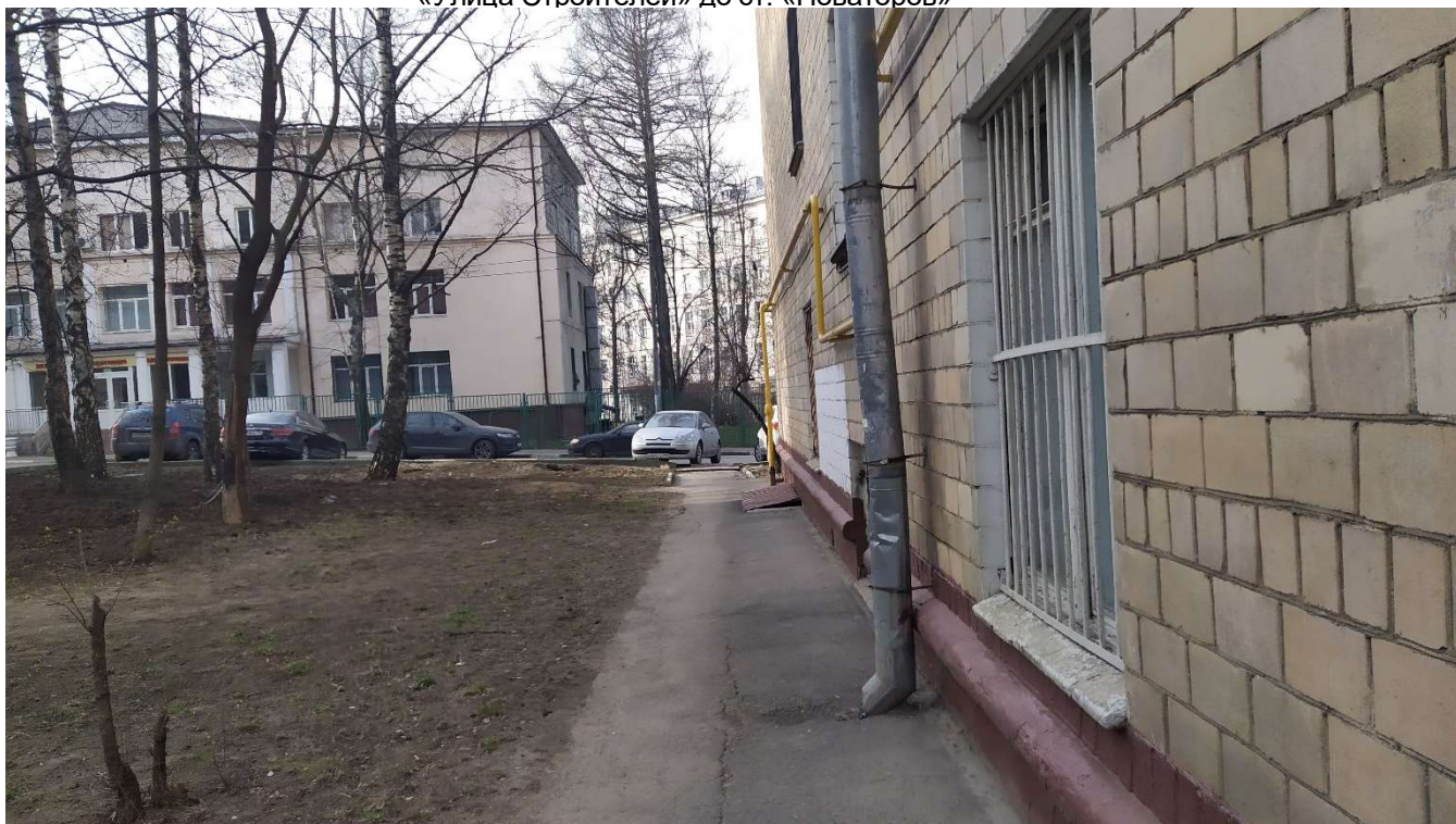
Фото 22. Состояние отмостки здания по адресу: г. Москва, Ленинский проспект, д. 78.
