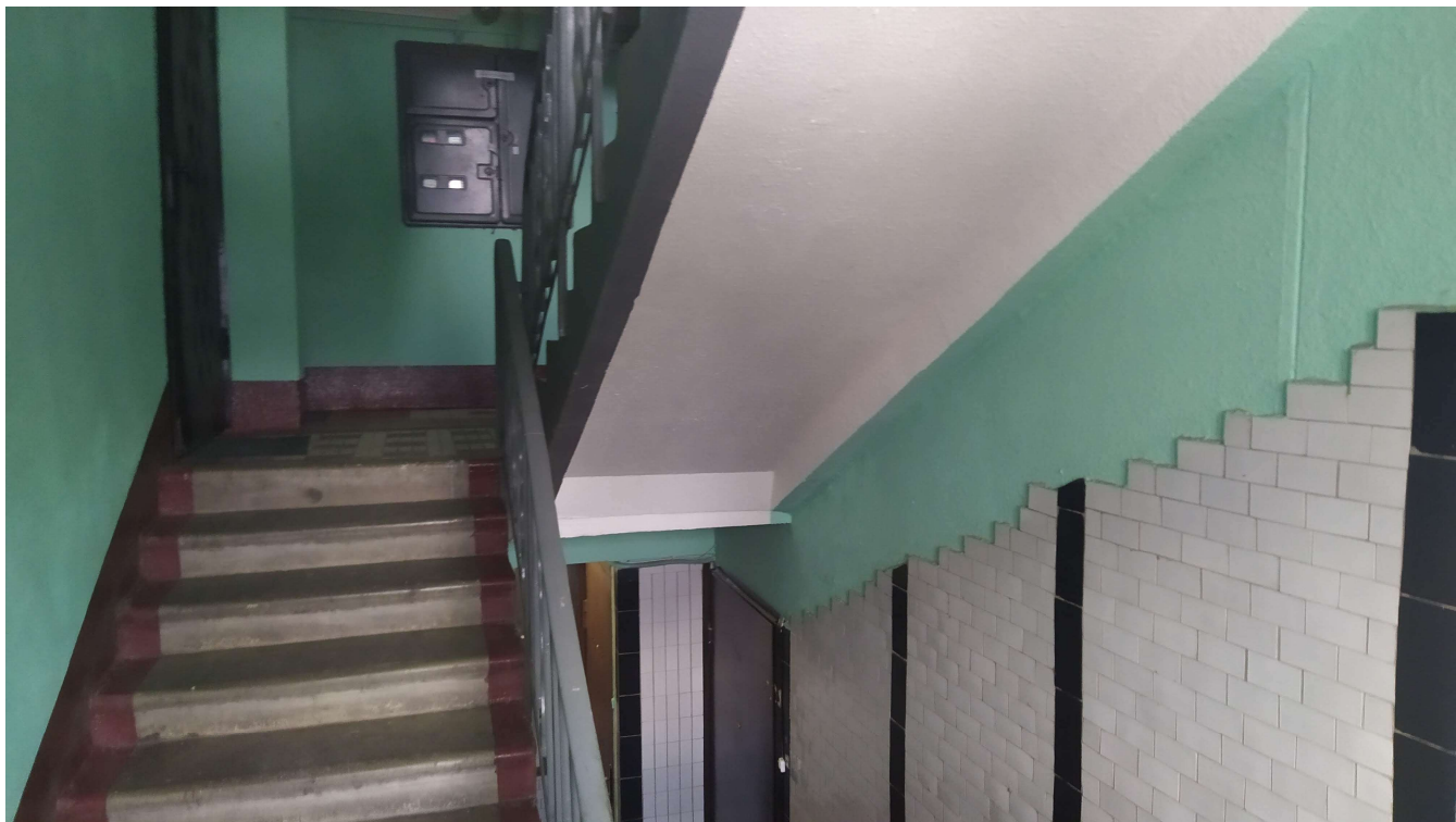
Фото 30. Общее состояние лестничных маршей здания по адресу: г. Москва, Ленинский проспект, д. 78.
