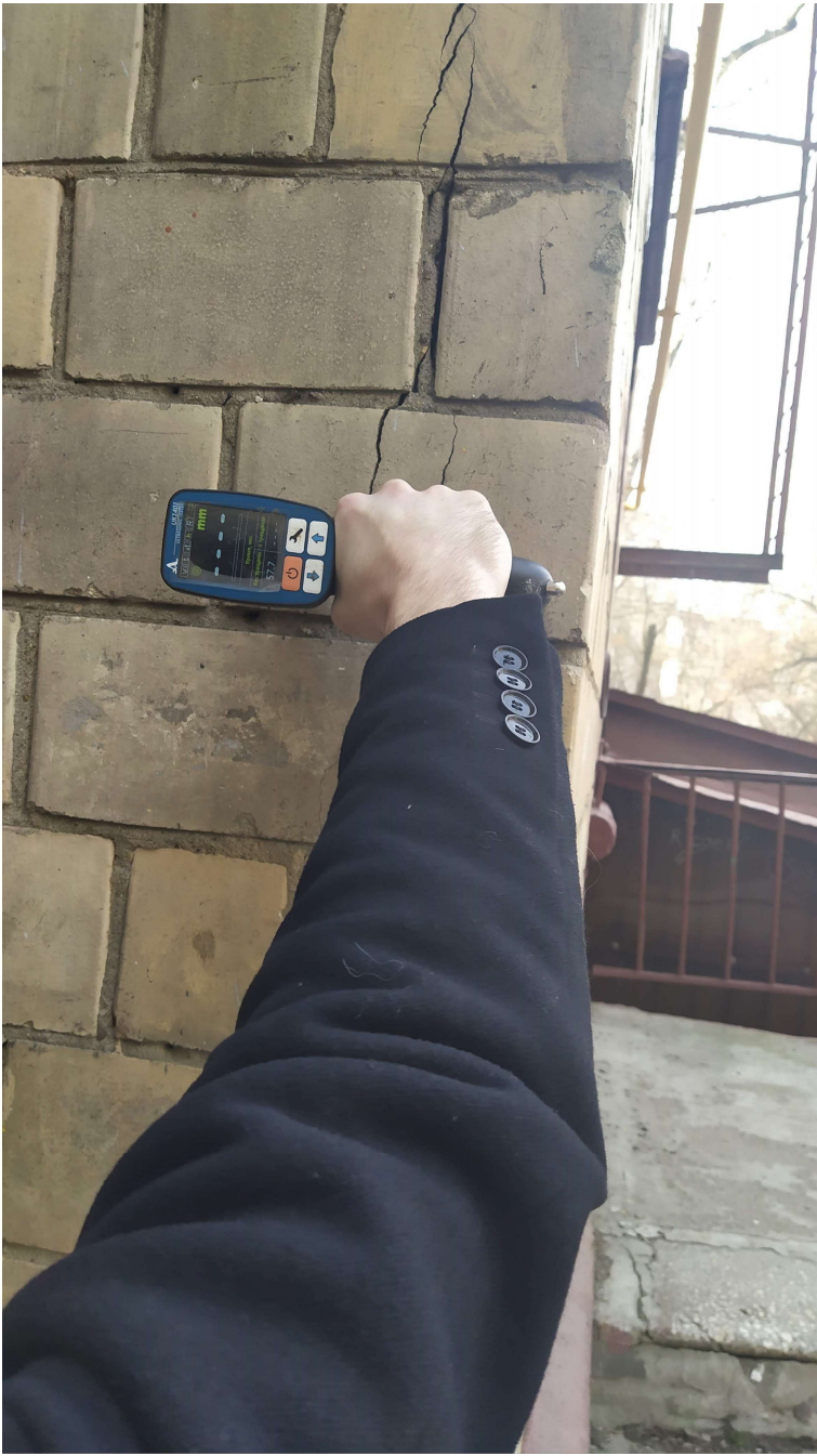
Фото 16. Измерение трещины фасада здания при помощи измерителя прочности бетона, по адресу: г. Москва, Ленинский проспект, д. 78.
