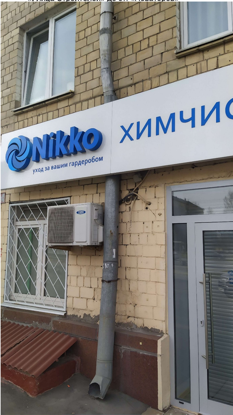
Фото 25. Трещина фасада здания по адресу: г. Москва, Ленинский проспект, д. 78.
