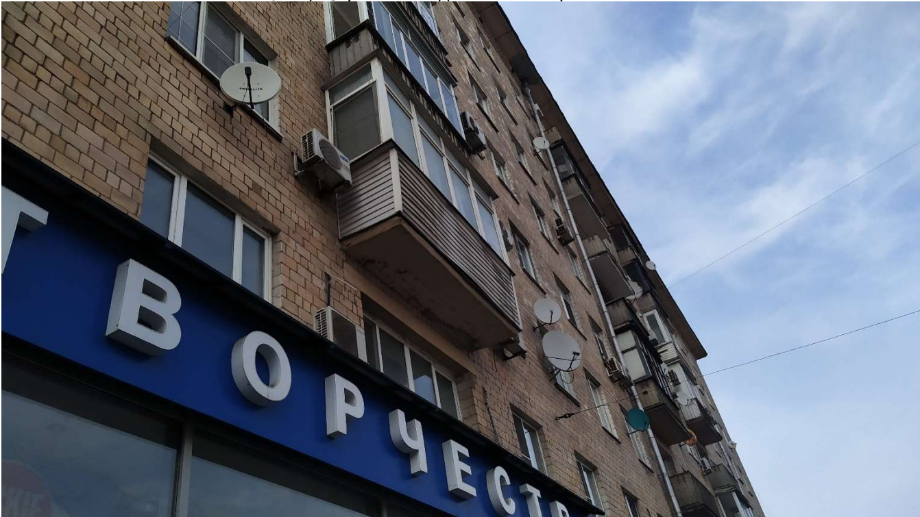
Фото 26. Состояние балконной плиты здания по адресу: г. Москва, Ленинский проспект, д. 78.
