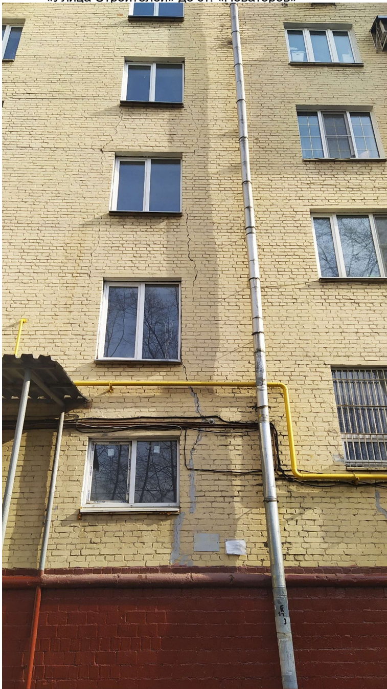
Фото 13. Трещина фасада здания по адресу: Москва, Ленинский проспект, д.78.
