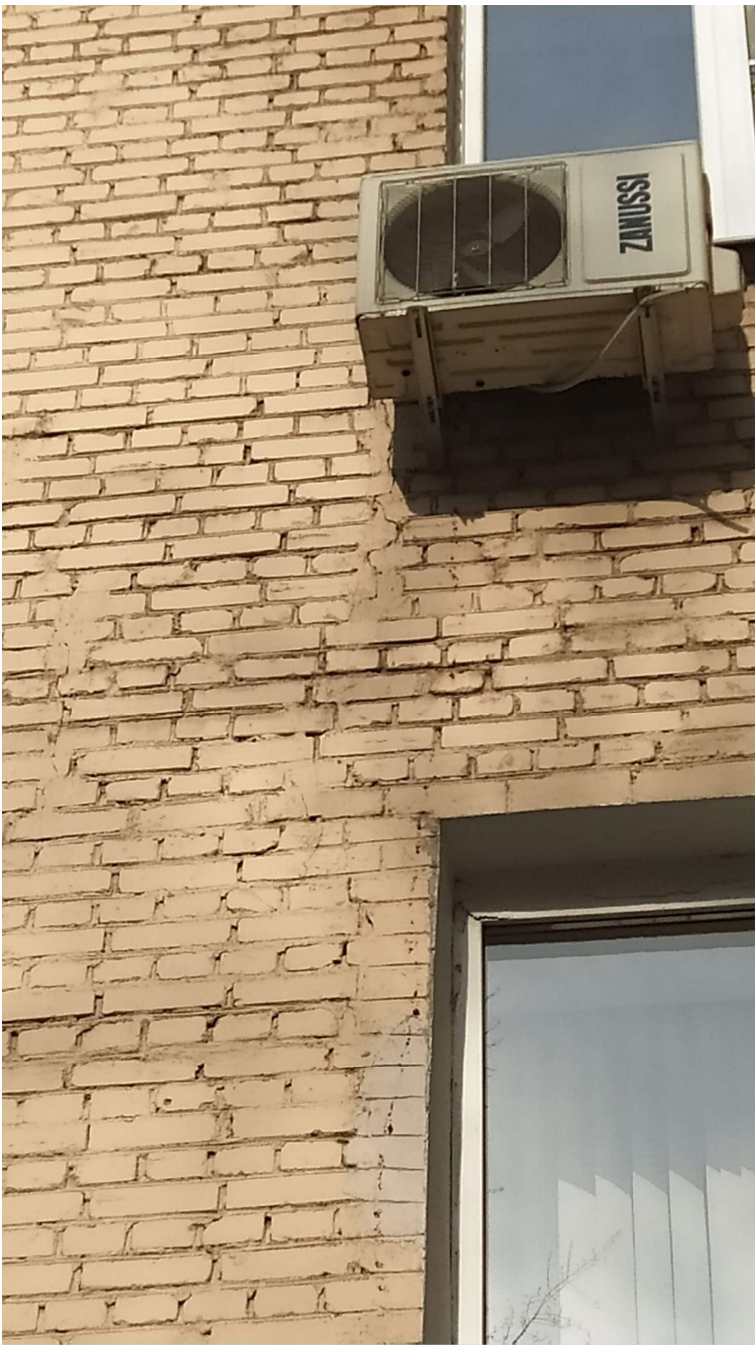
Фото 7. Трещина фасада здания по адресу: Москва, Ленинский проспект, д.78.
