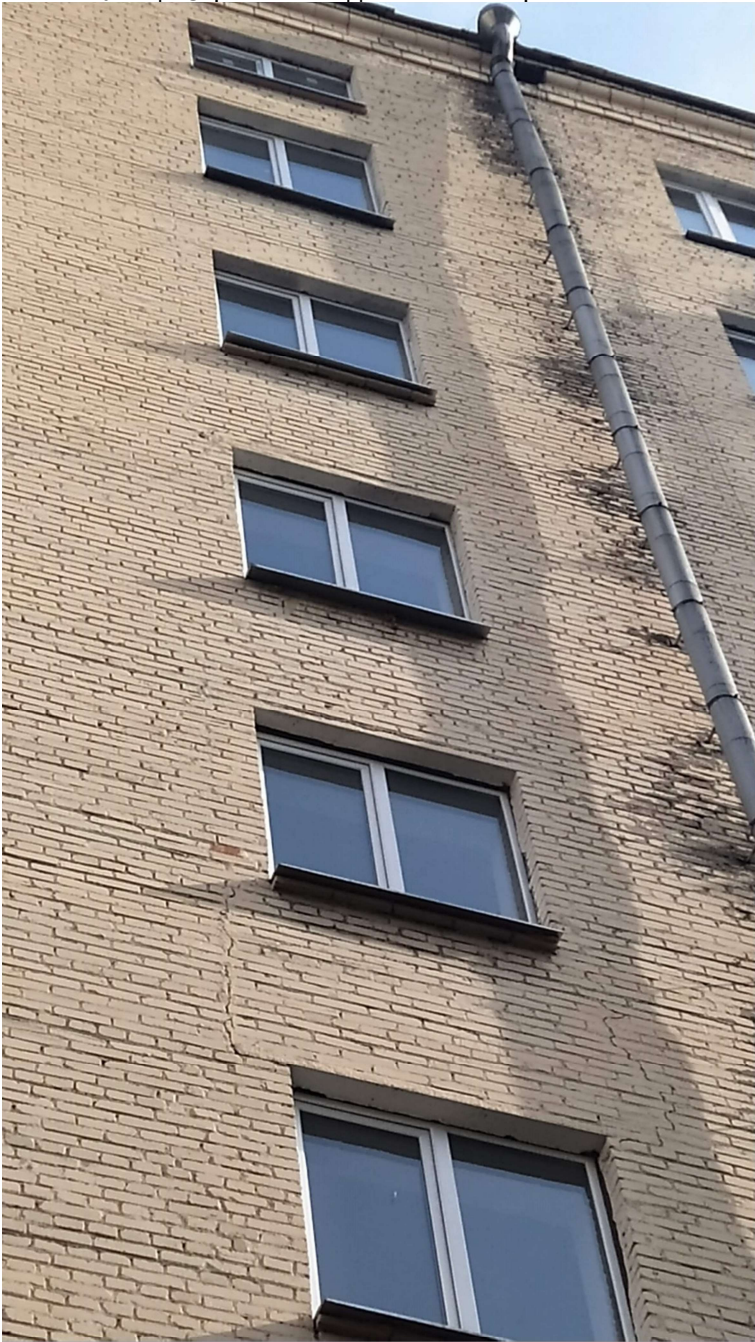
Фото 12. Трещина фасада здания по адресу: Москва, Ленинский проспект, д.78.
