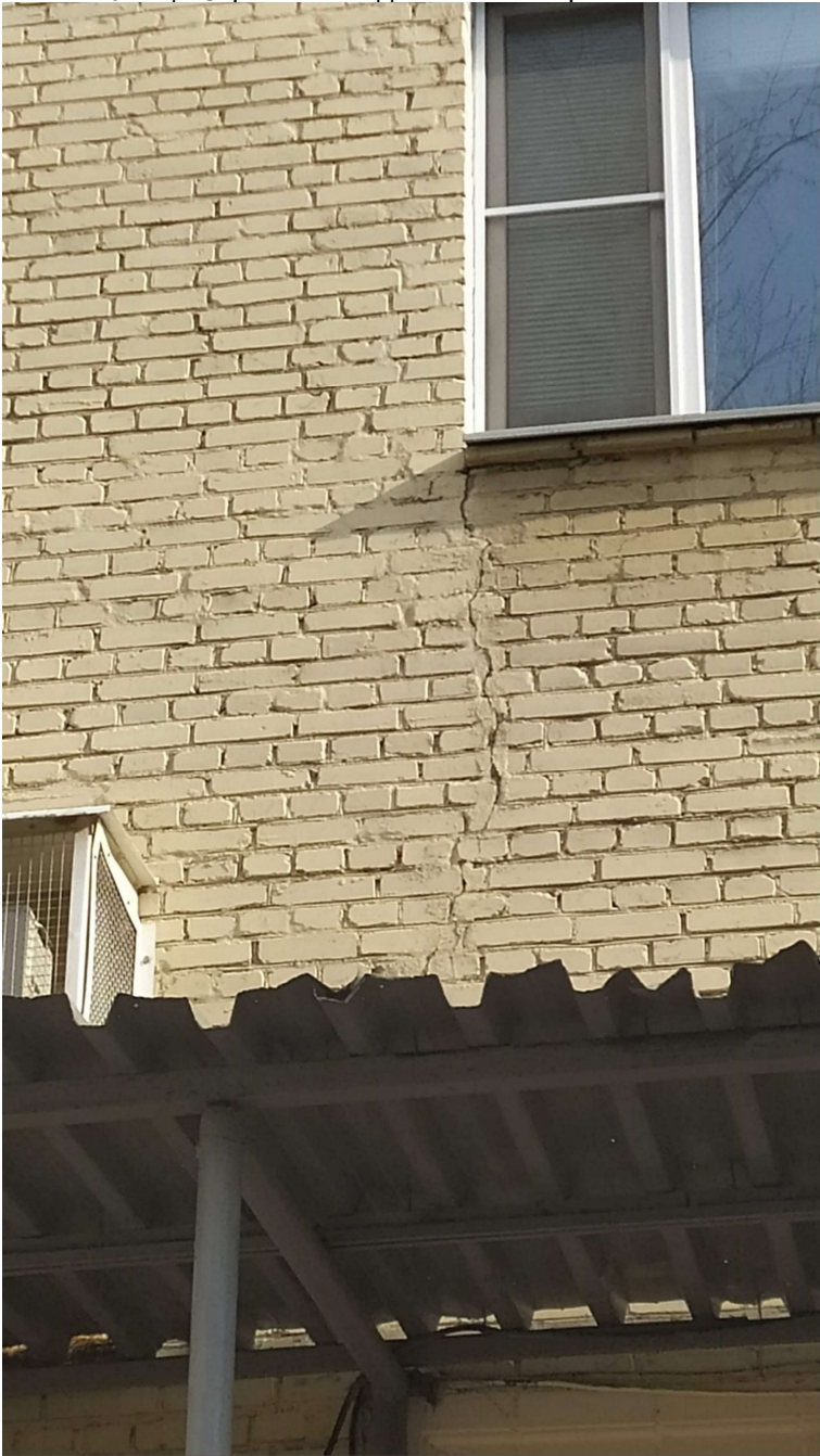
Фото 11. Трещина фасада здания по адресу: Москва, Ленинский проспект, д.78.
